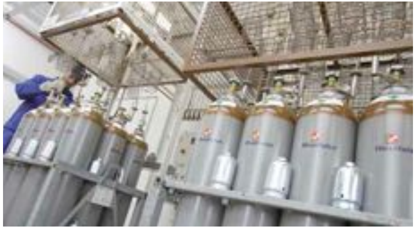
Die Reinstgase-Abfüllung erfolgt getrennt von anderen Gasen. Hierfür besteht ein eigener Flaschenpark.
